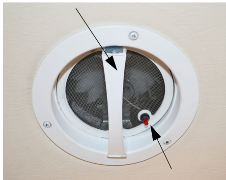
Fan Power Switch
